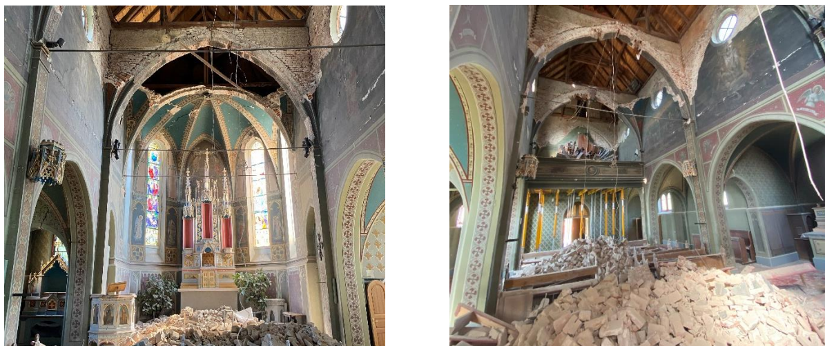
Slika 1.1 Fotografije oštećene župne crkve u Granešini, nastradale u potresu 22.3.2020.
