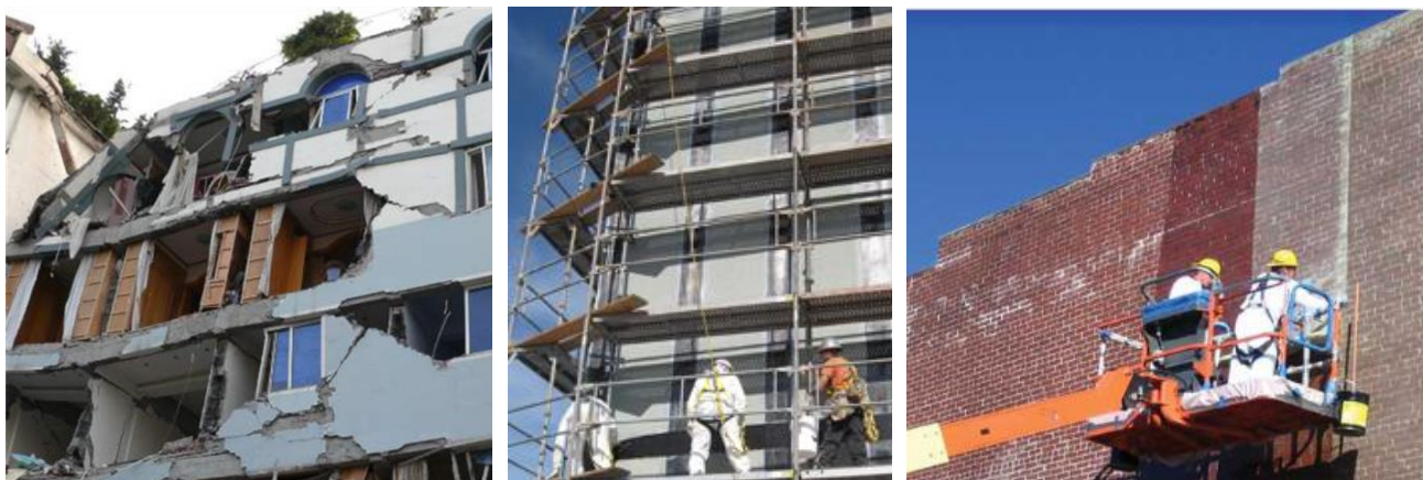
Slika 2.80 Prikaz oštećenja (lijevo) i izvedba FRP traka (sredina i desno) [8]
