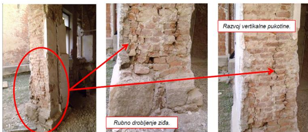
Slika 2.38 Oštećenja zidanih stupova
